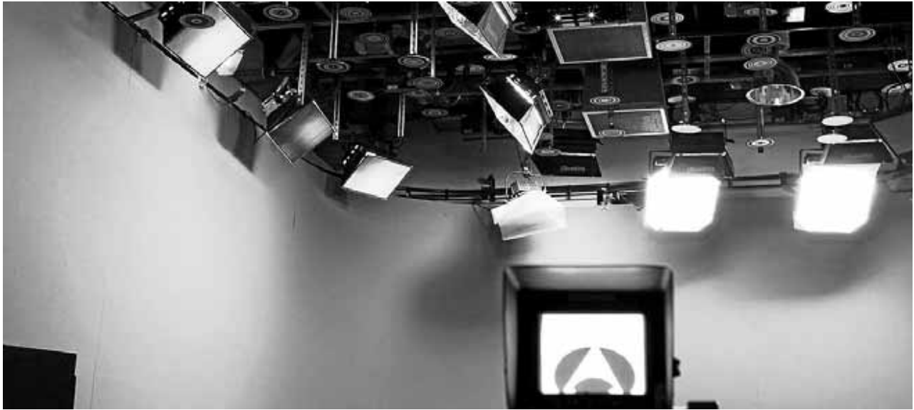
Antena 3 ha implantado en sus platós de televisión distintas medidas de eficiencia energética.
